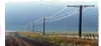
ระบบจำหน่ายแรงดัน 22KV และ 33 KV
