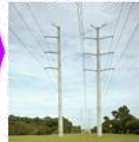
ระบบสายส่งแรงสูง 115KV
