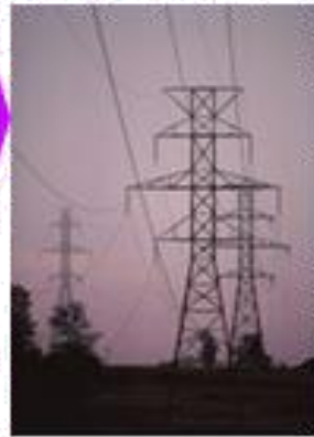
ระบบสายส่งแรงสูง 230KV - 500KV
