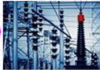
สถานีไฟฟ้าย่อย แรงดัน 230KV - 500KV
