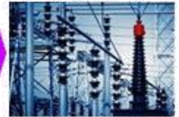
สถานีไฟฟ้าย่อย แรงดัน 115KV
